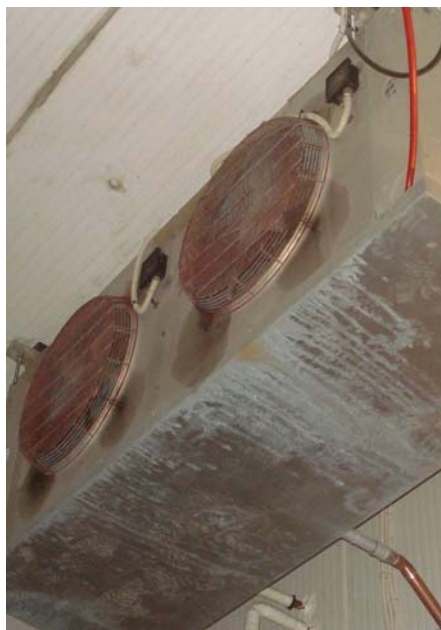
Εικόνα 7.1. Ψυκτική μονάδα στο εσωτερικό θαλάμου αποθήκευσης.
