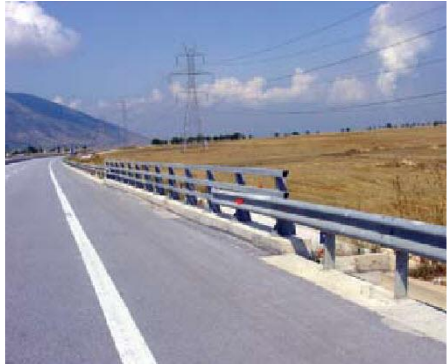
Ειδικά στηθαία ασφάλειας σε γέφυρα ελληνικού αυτοκινητόδρομου
