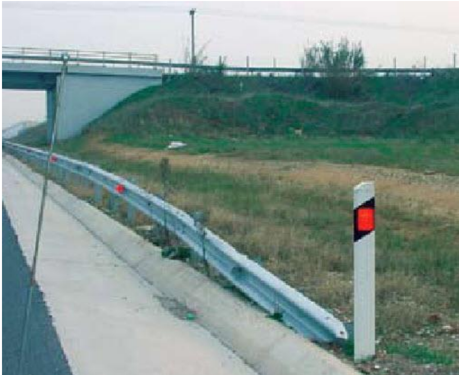
Μεταλλικά στηθαία ασφάλειας σε δεξιό άκρο ελληνικού αυτοκινητόδρομου
