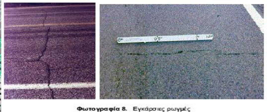
Φωτογραφία 7. Ρωγμές συστολής ή συρρίκνωσης
