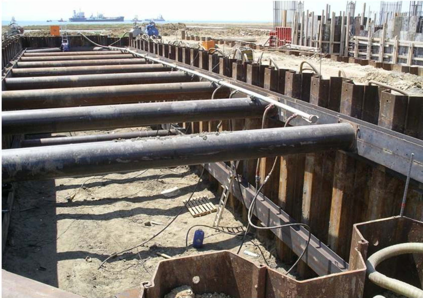
Σχήμα 10.28. Διάταξη στοιχείων αντιστήριξης και συστήματος wellpoints κατά το δεύτερο στάδιο εκσκαφής (βάθος -5.0 m)
