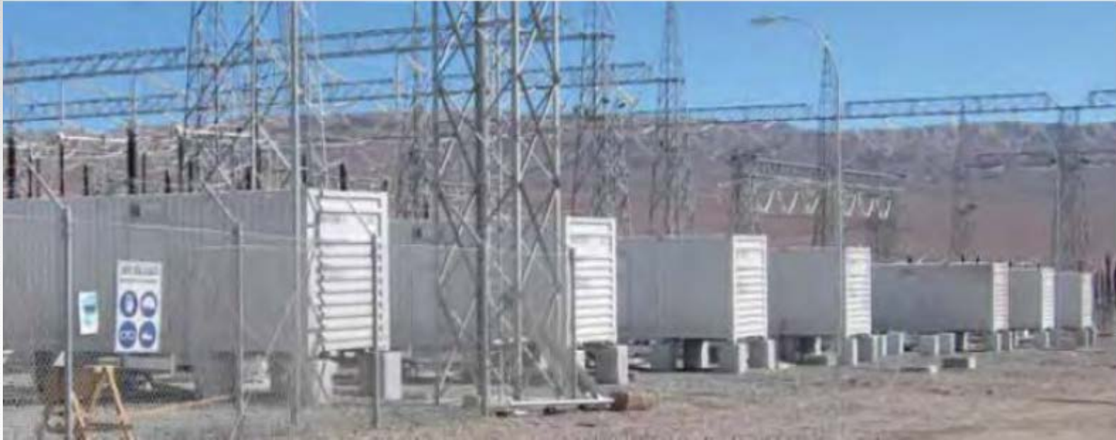
Υποσταθμός 12 MW με μπαταρίες Li-ion στο Los Andes (Χιλή)
