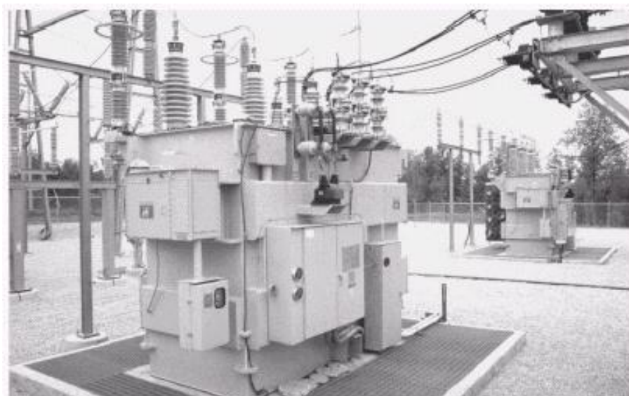
Τριφασικός ΜΣ 20MVA, υψηλής τάσης, με Tap Changer (διαίρεση τάσης)
