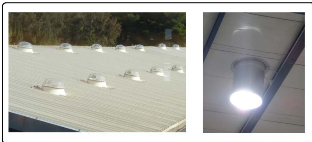
Σχήμα 7.96: Τυπική εγκατάσταση ηλιοσωλήνων. (Φωτ. Ν. Αλούπη, TAM, ΠΘ).
