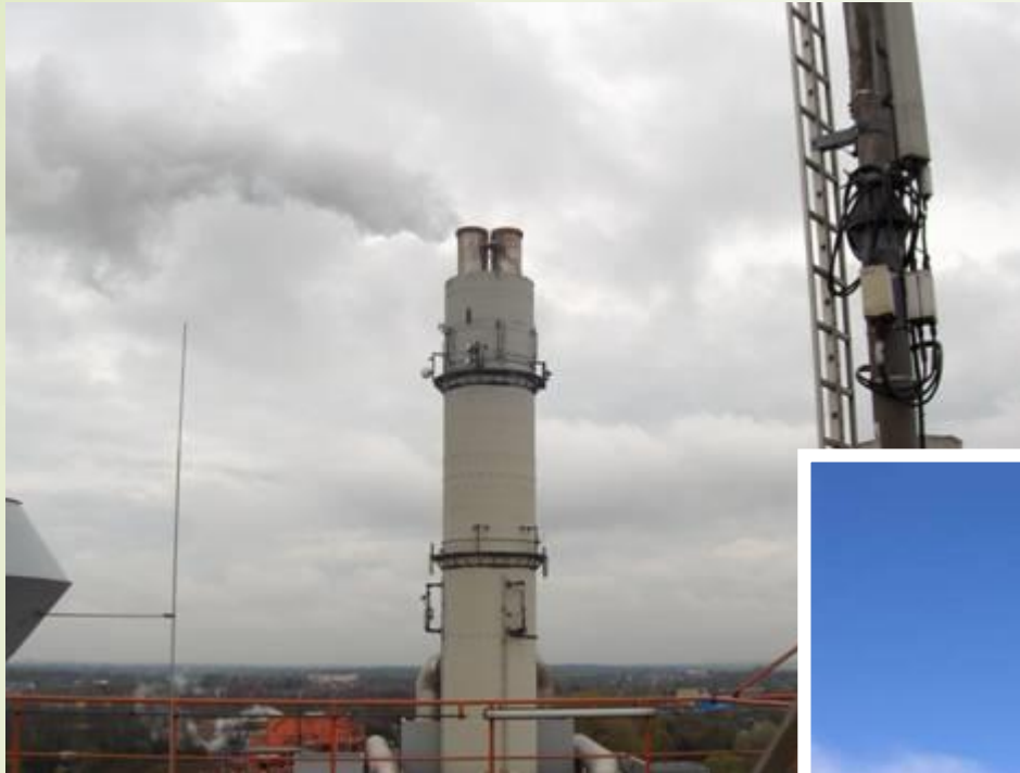
Καμινάδα του κρατικού Γερμανικού εργοστασίου καύσης (Αμβούργο).
