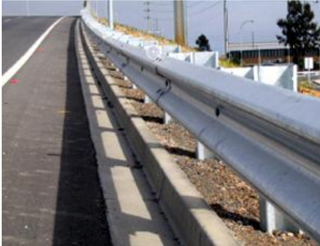
Εικόνα 6.1.2: Στηθαίο ασφάλειας στα όρια του δρόμου
