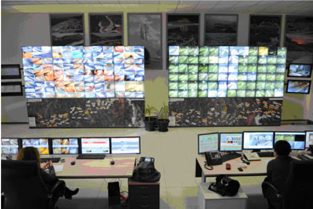
Εικόνα 3.7: Κέντρο ελέγχου κυκλοφορίας
