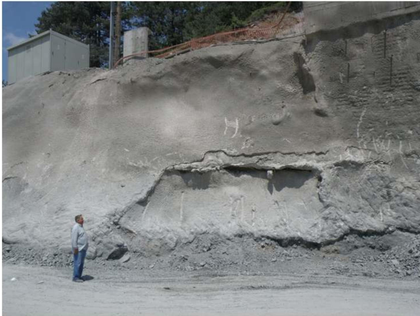
Σχήμα 9.9. Θέση κατασκευής του τοίχου ΤΣ1 στην είσοδο της σήραγγας Συρτού σε κοντινό πλάνο
