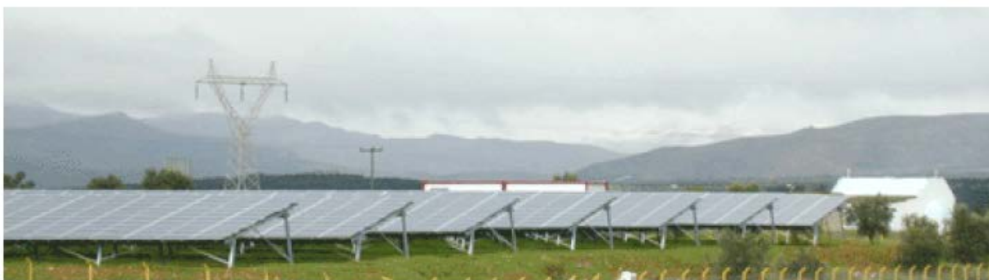
Φωτοβολταϊκός σταθμός ηλεκτροπαραγωγής (μεσαίου μεγέθους)
