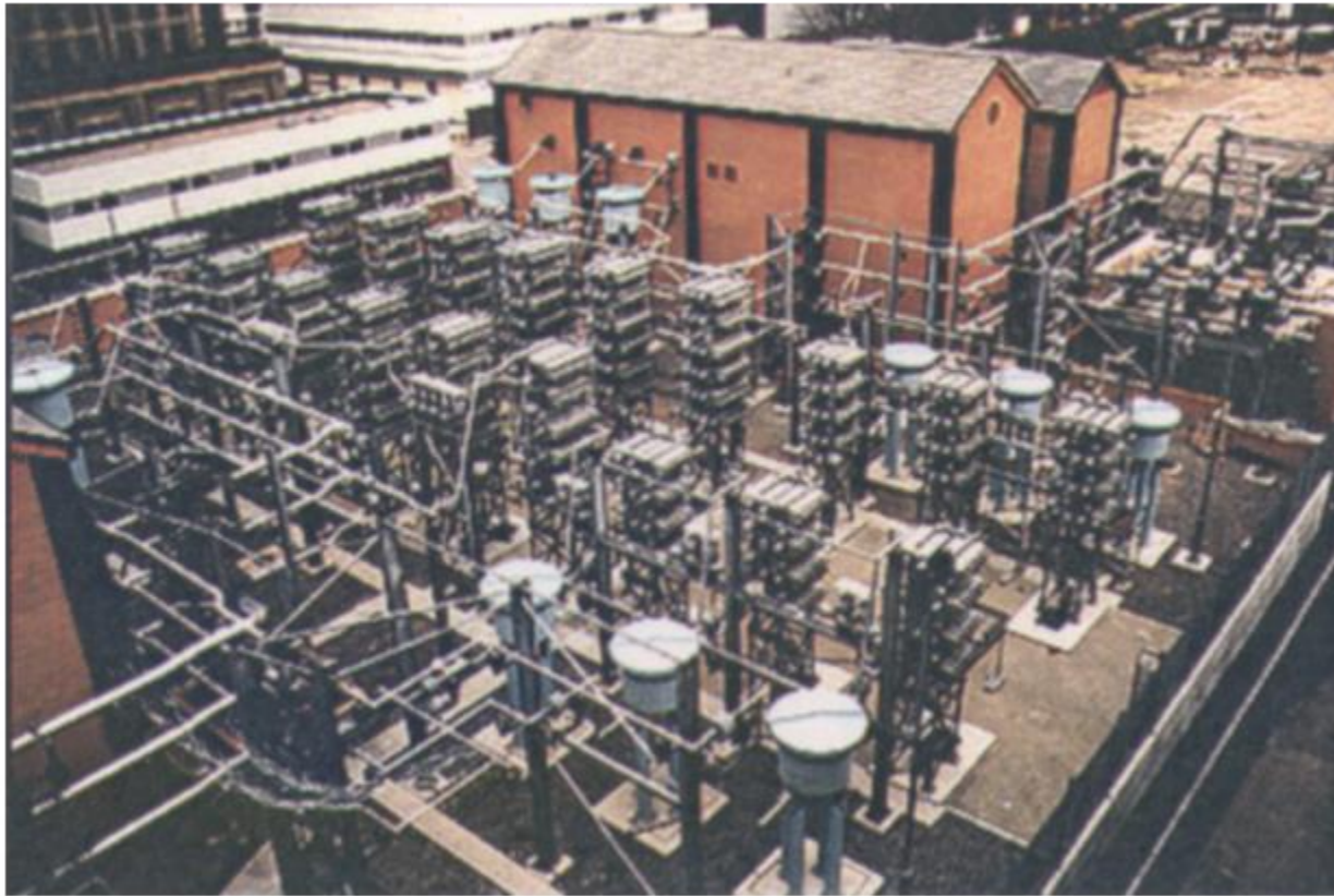
Σταθμός SVC στο Λονδίνο
