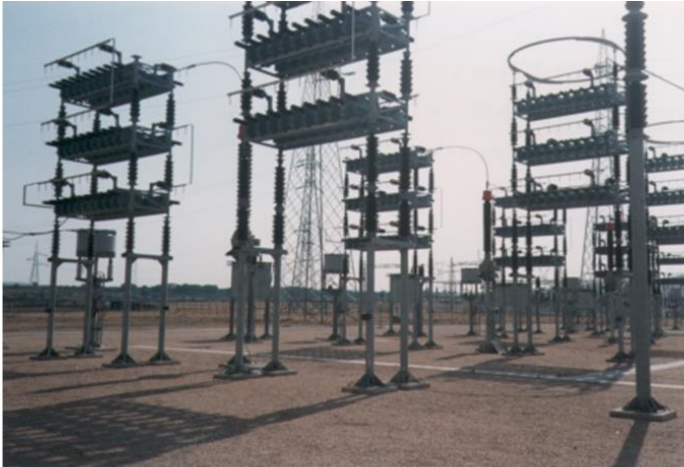
Τράπεζες πυκνωτών υψηλής τάσης.
